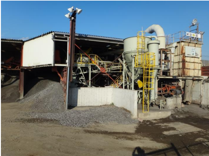
・リサイクルプラント全景
