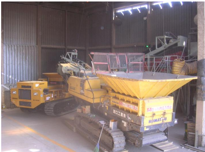
・木くず破碎施設
